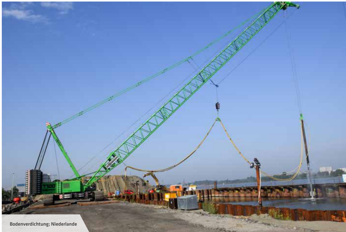
Hohe Stabilität im anspruchsvollen Offshore Einsatz; Niederlande
